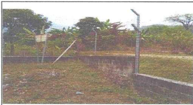
foto 3. el trabajo realizado se esta perdiendo por no terminarlo
