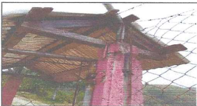
foto 5. Porton de la entrada esta deteriorada
