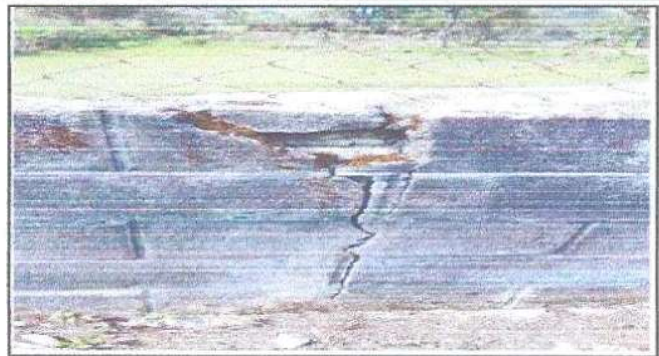
foto No. 2: La pared se desprende por falta de mantenimiento
