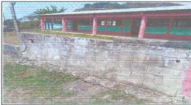
foto No. 1: Se observa el desgaste y el deterioro del muro
