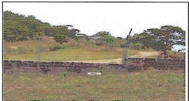
foto 4. se necesita mantenimiento y cambio de partes de las paredes
